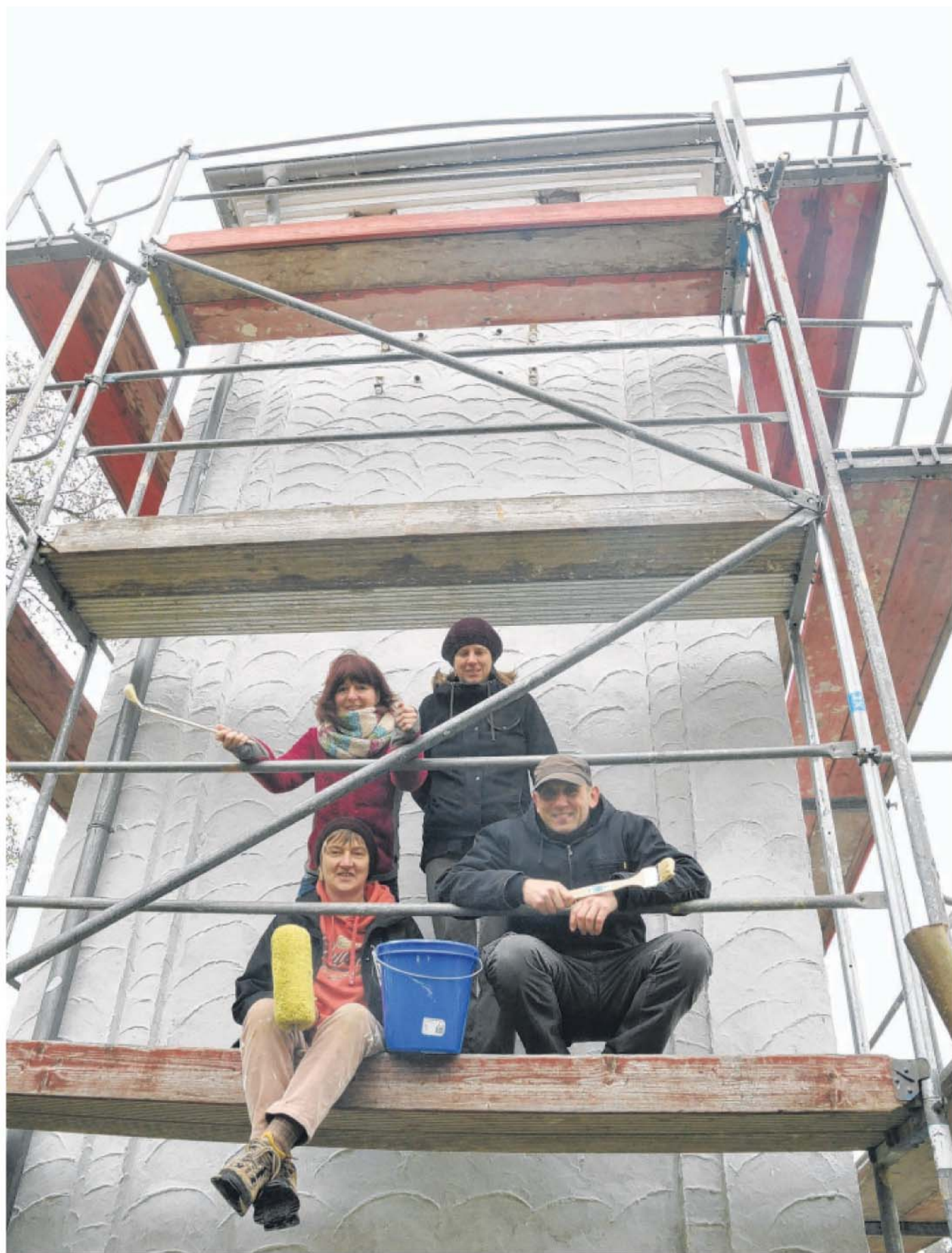
Noch viel zu tun: Um dem alten Trafohäuschen in Bardüttingdorf einen neuen Anstrich zu verpassen, sind Monika Storm, Jörg Gumpert (vorne v. l.), Iris Westermeier und Yvonne vom Hofe (hinten v. l.) mit Pinseln und Eimer aufs Gerüst geklettert. FOTO: STEFANIE BOSS
