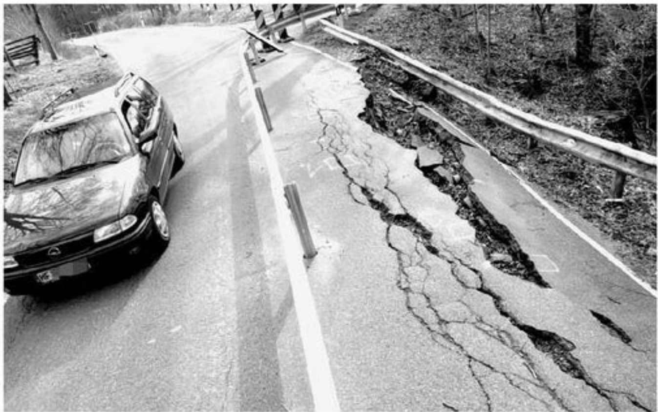
Massive Schäden: Eine Fahrbahnseite der Düttingdorfer Straße ist abgerutscht.
